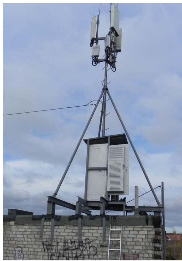
Рис. 8. Антенны и аппаратная, смонтированные на опоре
