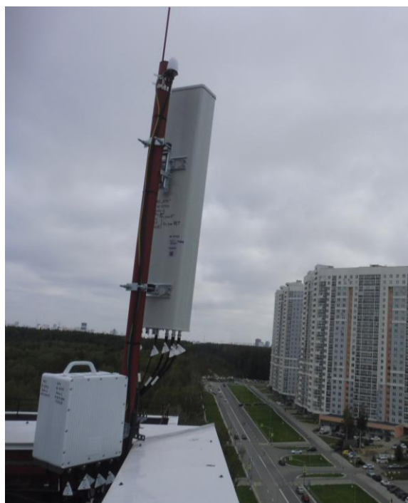
Рис. 5. Размещение антенны на трубостойке, закрепленной на конструктивном элементе здания
